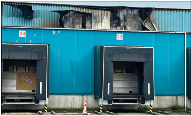
Branden havde haft godt fat i tagkonstruktionen i lagerbygningen Foto Helle Hockerup
